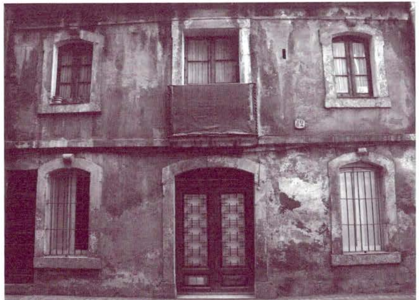
Habitatge en mal estat a la Barceloneta. Foto Arxiu Territori
